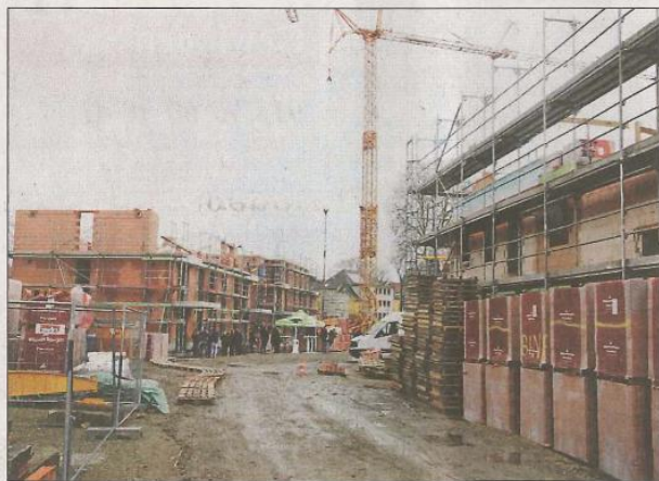
Noch stehen die Häuser im Rohbau, sind die Wege nass und schlammig.
